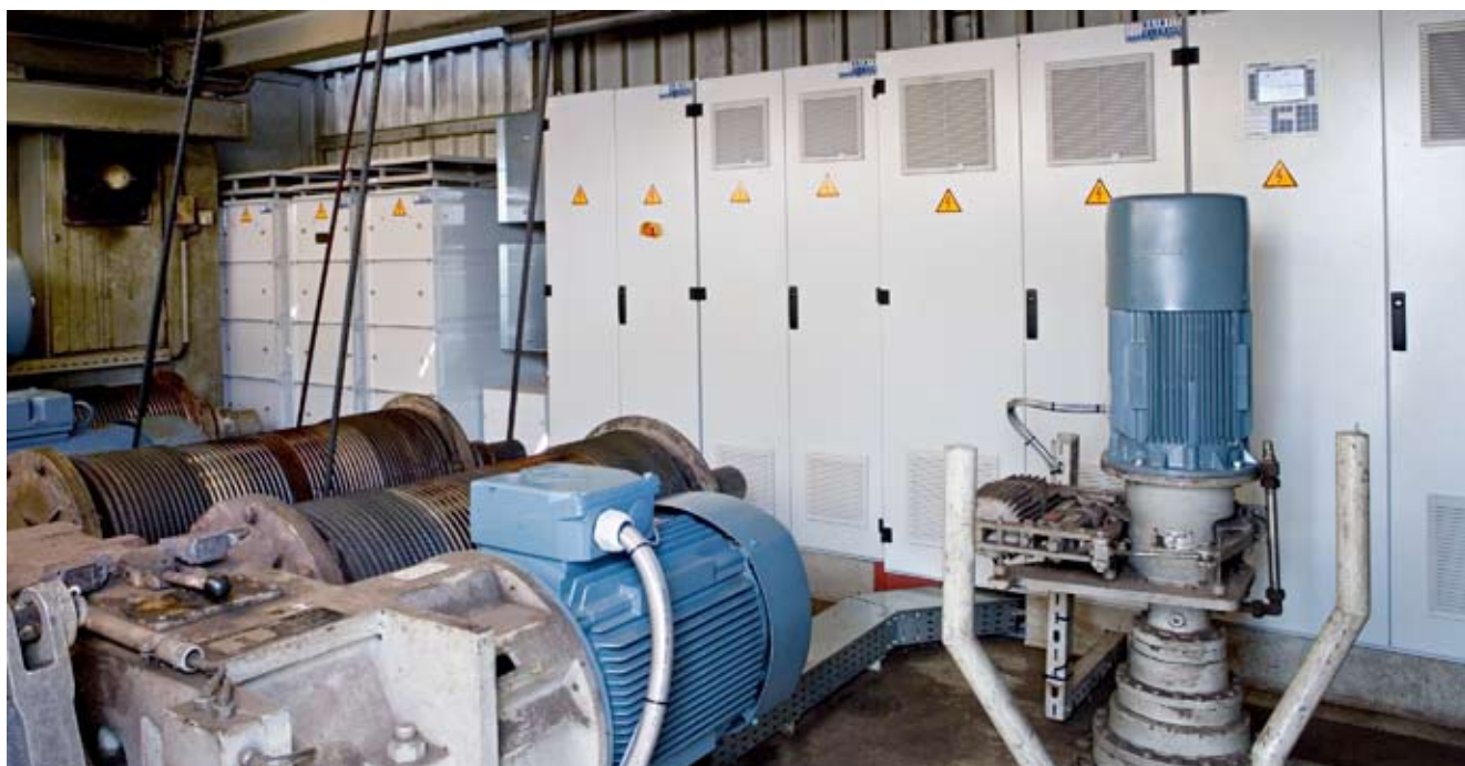
Het was de taak van Emotron de techniek te ontwikkelen, de motoren te leveren, de kastapparatuur te construeren en het systeem in bedrijf te nemen.
