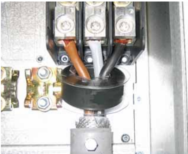
Fig. 55 Noyau en ferrite monté sur les câbles de moteur
